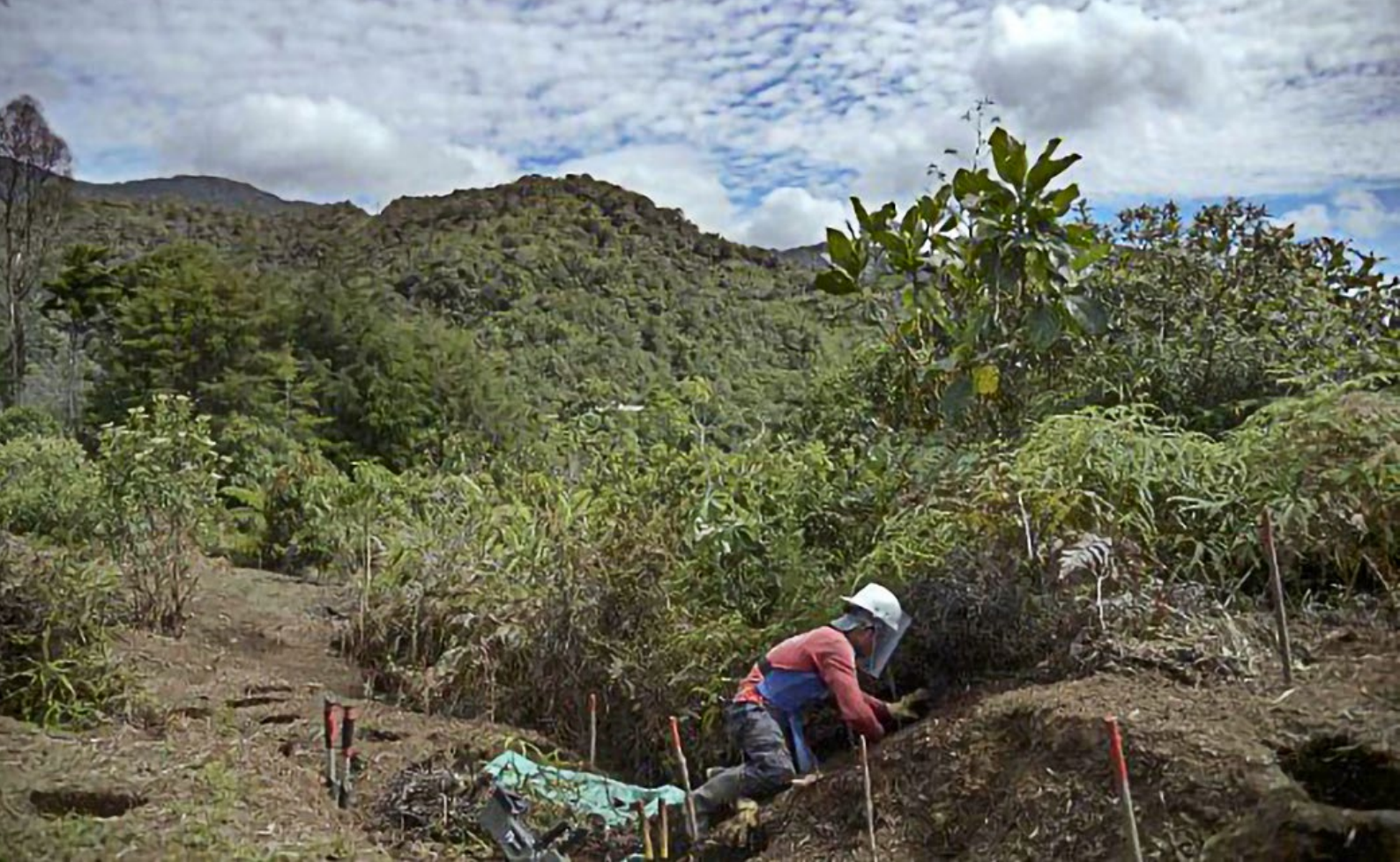
Une ZDC avec une végétation dense et des engins explosifs difficiles à atteindre en Colombie. Crédit photo © GICHD.
